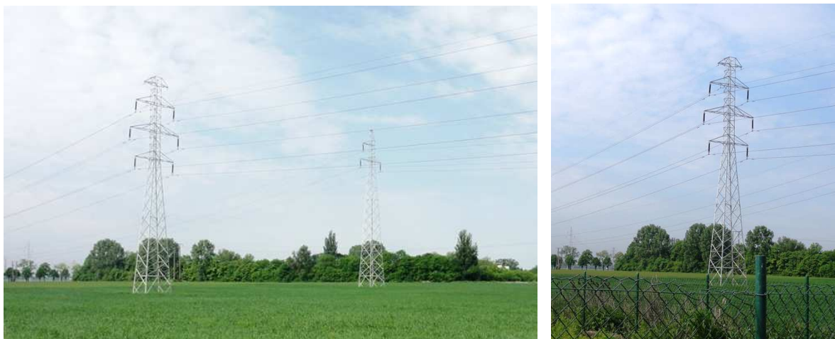
Fot. 9 Napowietrzna linie elektroenergetyczne 110 kV przechodzące przez sołectwo Ksawerów-Zachód
